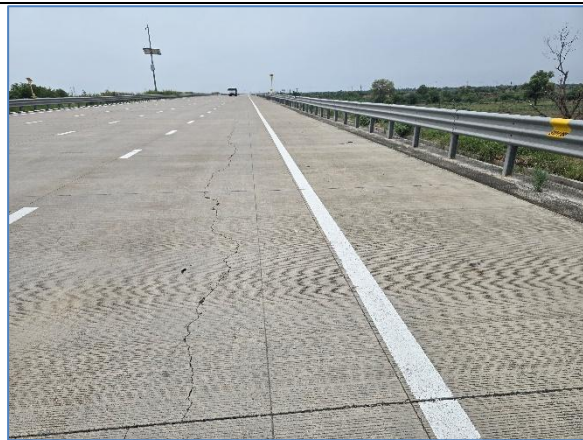
Longitudinal Cracking @ Km 310.100 RHS
